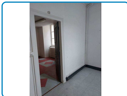
D.O. n° 2 sur Mur Plaque(s) plane(s) fibres- ciment Toile de verre peinte / B
